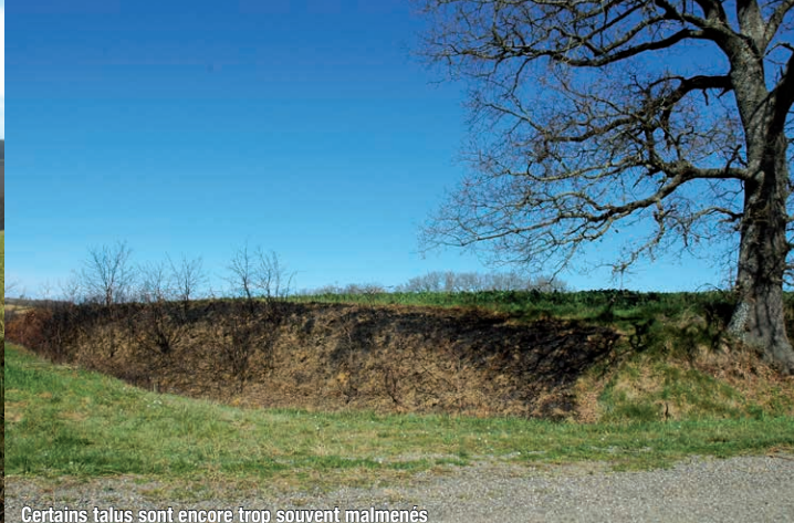
Certains talus sont encore trop souvent malmenés
