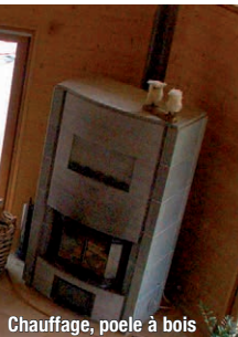
Chauffage, poêle à bois
